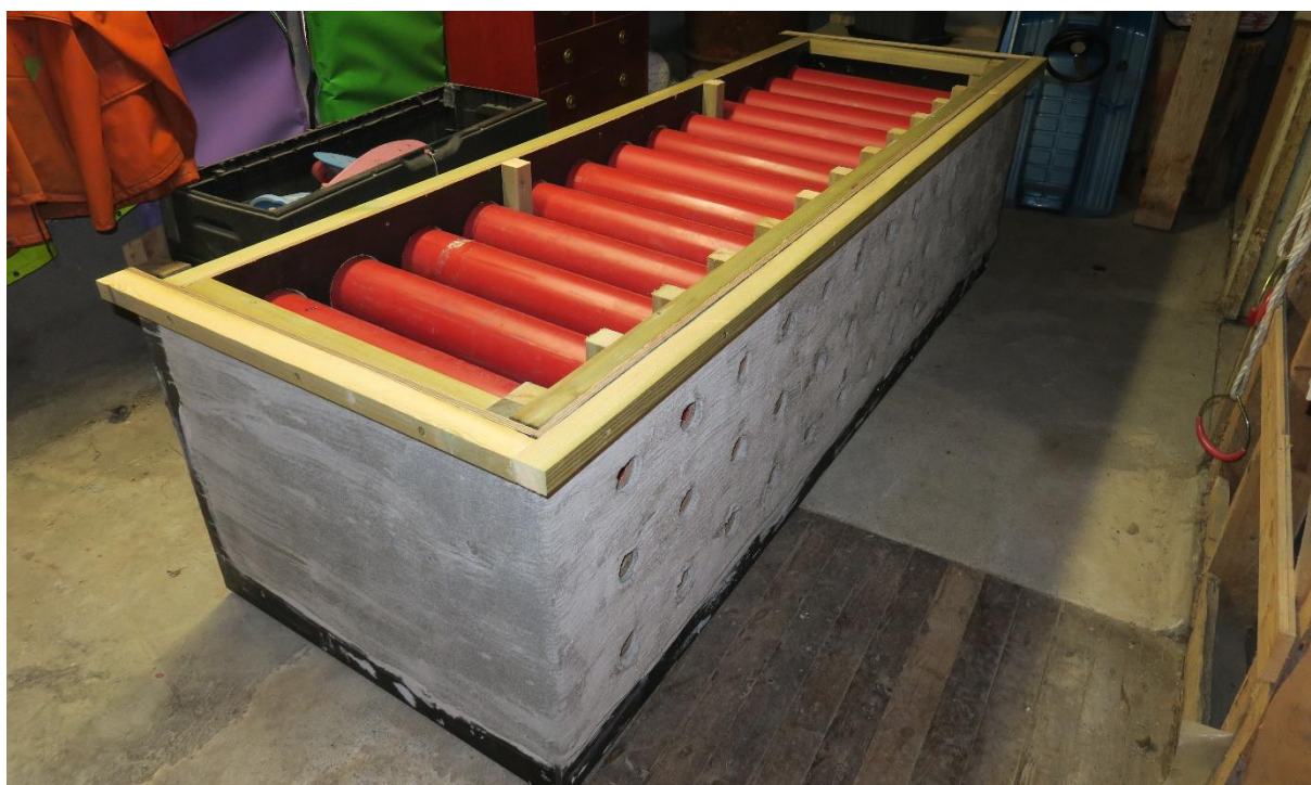
Figur 9. Sandsvalebygget under bygging. Bildet viser 125mm-rørene som fungerer som både reirganger og hekkekammer.
